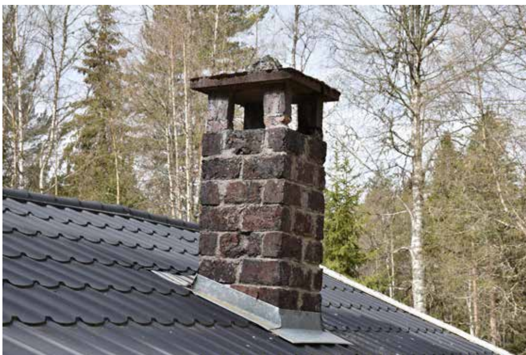
Fint murad skorsten i småskaliga slaggblock, troligen kopparslagg. Skorstenar i slagg är ovanliga och besitter mycket höga bevarandevärden. Tibble 8:13.
